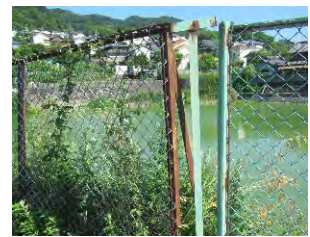
安全柵の破損状況
