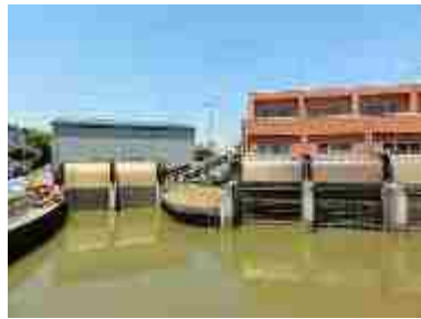
○○排水機場 (○○市○○町○○地内)
