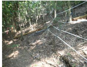
破損と仮補修(春日山3-2)
