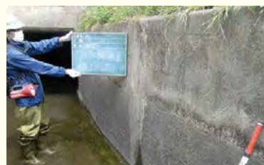
●幹線水路踏査 水を流す前に幹線水路を歩いて異常がないか点検します。
