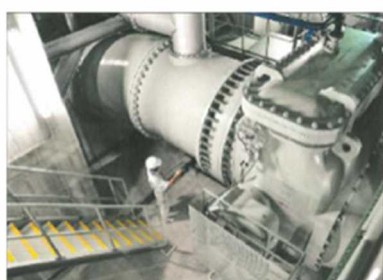
雨水ポンプの整備
