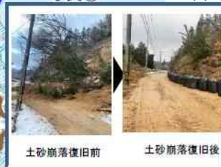
県道285号崩落箇所緊急復旧
