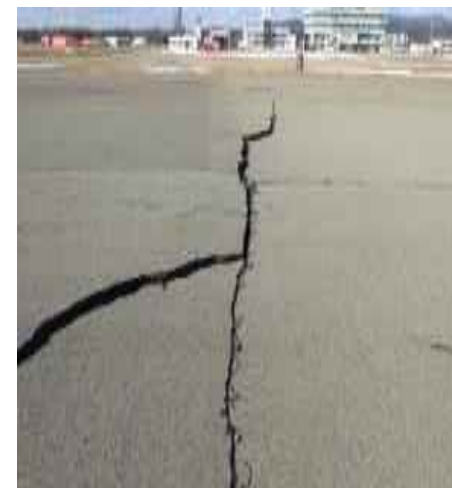
(空港)亀裂の発生
