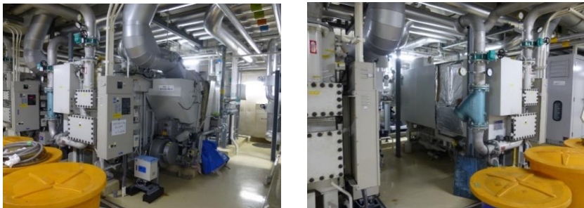
地下1階機械室 冷温水発生機RB-2
