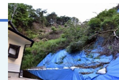
豪雨の度に 土砂崩れが多発
