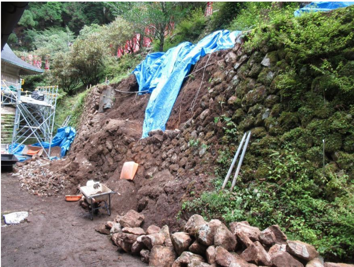
茶屋前 石垣崩落時写真（令和3年3月）
