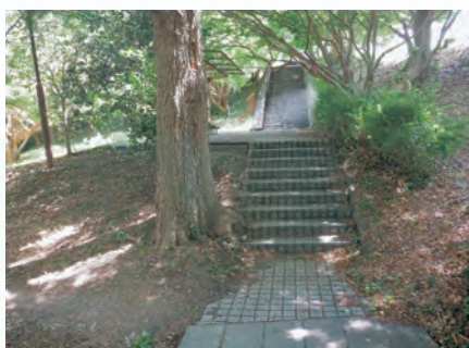
手すりのない階段
