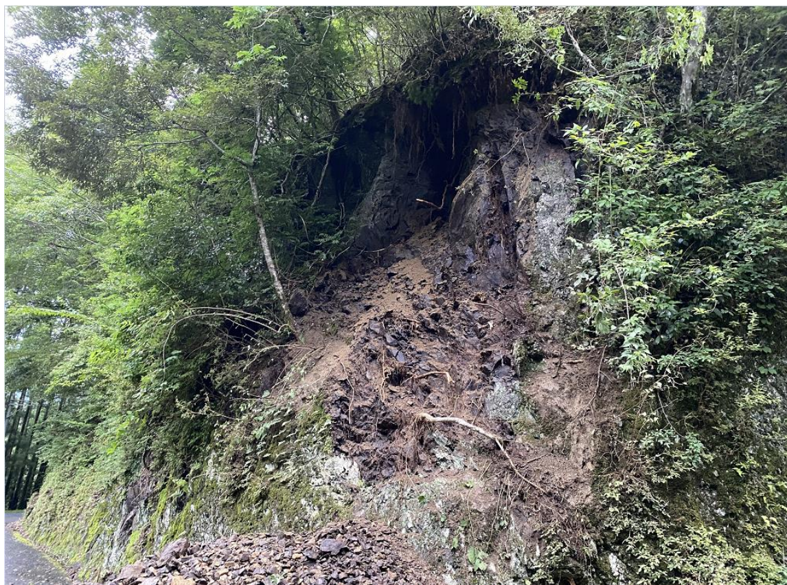
6/29 崩土現場写真 (国道425号十津川村小坪瀬)
