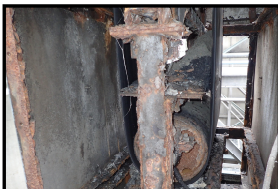
処理施設(焼却炉)
