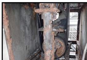
処理施設（焼却炉）
