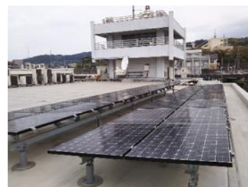
太陽光発電設備及び蓄電池の導入 (三郷町役場)
