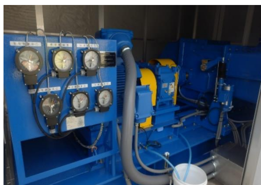
小水力発電設備の設置(御所浄水場)
