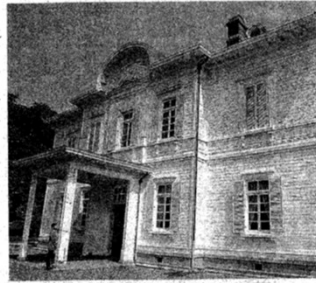
外壁の塗装が剥がれ、劣化が目立つ仁風閣
