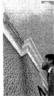
内部では、雨漏りなどが原因で天井の漆喰の一部が剥がれ落ちている（いずれも鳥取市東町で）
