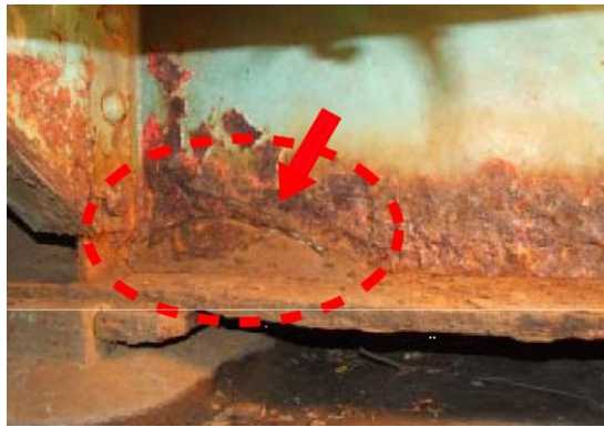
桁端部に発生した亀裂
