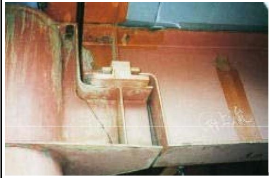
ゲルバー桁掛け違い部に発生した亀裂
