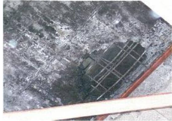
抜け落ちが発生した状況
