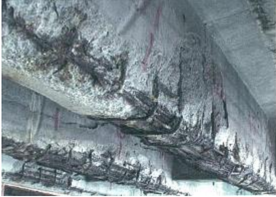
露出した鉄筋が破断（RCT 桁橋）
