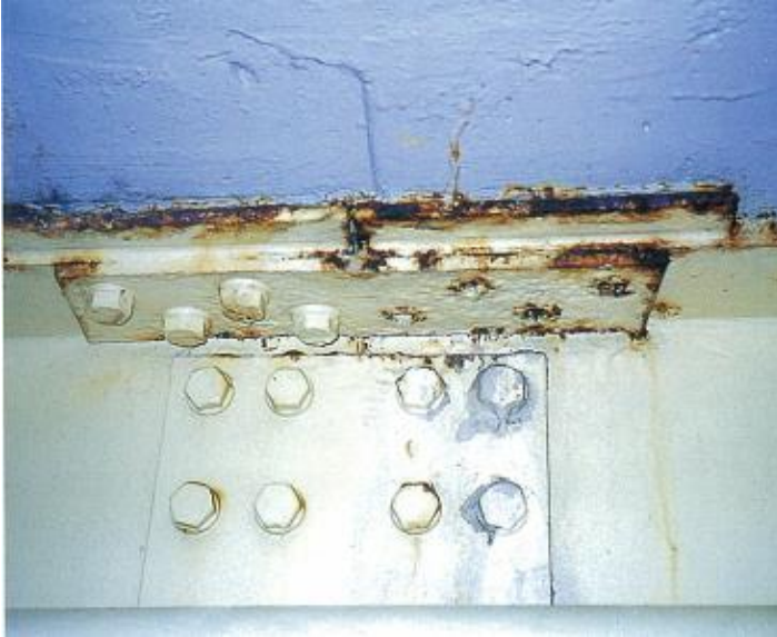
上フランジ接合ボルトが多数脱落
