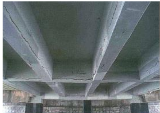
塩害劣化した RCT 桁橋
