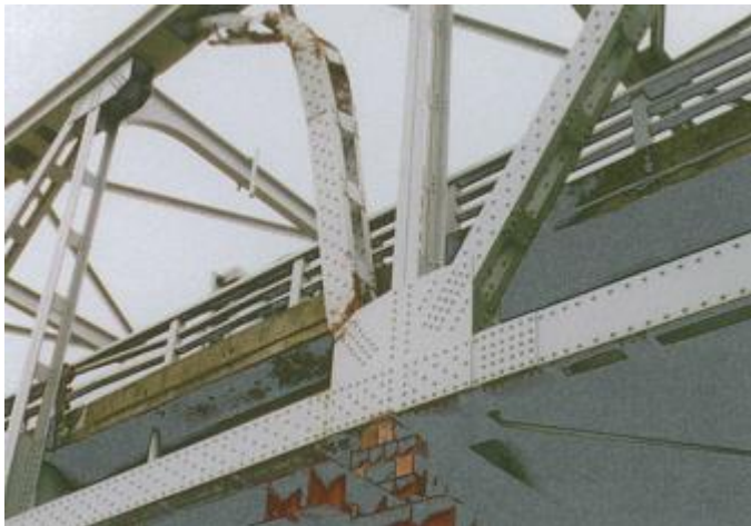
トラス橋斜材の破断
