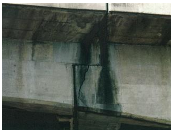
ゲルバー部のひびわれ
