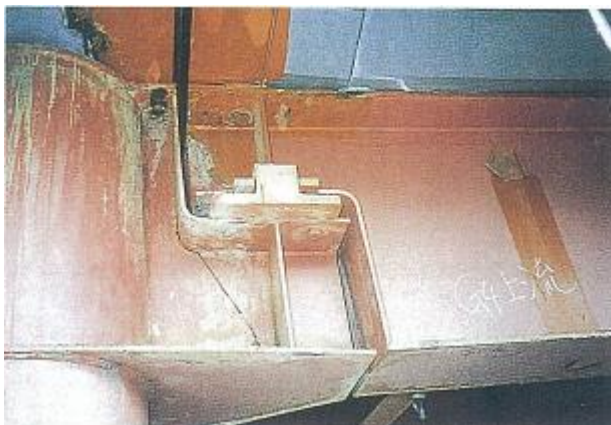
ゲルバー部に発生した亀裂
