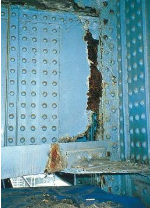
縦桁腹板の断面欠損
