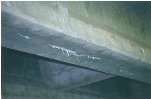
PCT 桁のひびわれ (遊離石灰を伴う)
