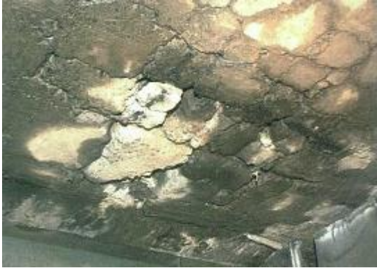
抜け落ち寸前の床版
