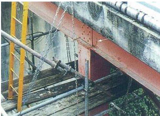
上路式アーチ橋の支柱部と補剛桁の取付け部に発生した亀裂
