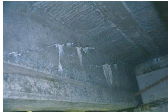
PCT 桁のひびわれ (遊離石灰を伴う)
