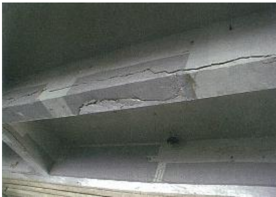
塩害劣化した RCT 桁橋
