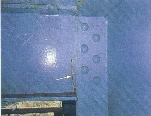
縦桁腹板に達した亀裂
