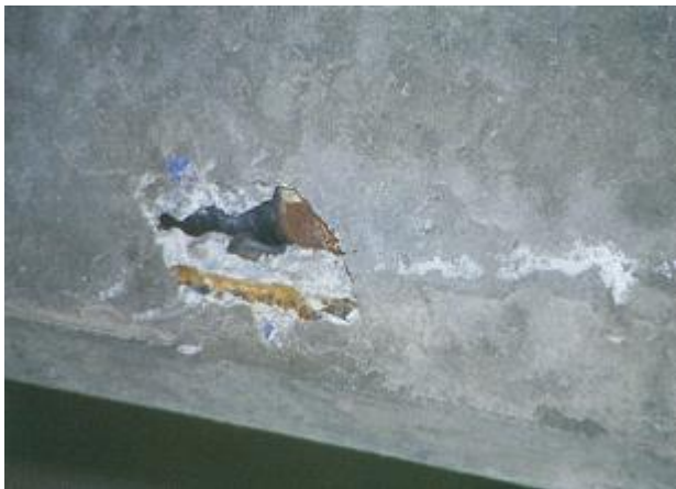
露出したシース管が腐食（PC 橋）
