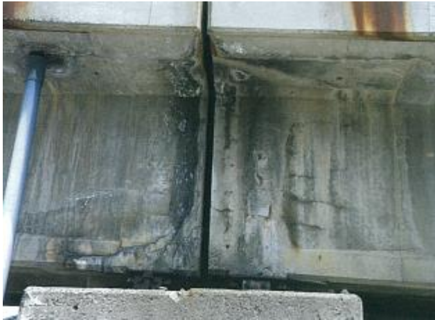
ASR と想定されるひびわれ (PCT 桁)
