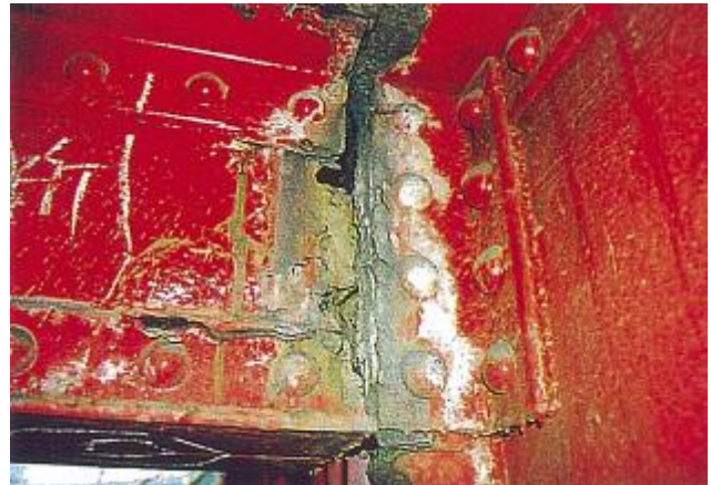
縦桁腹板の断面欠損
