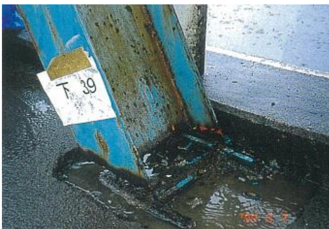
トラス橋斜材の破断
