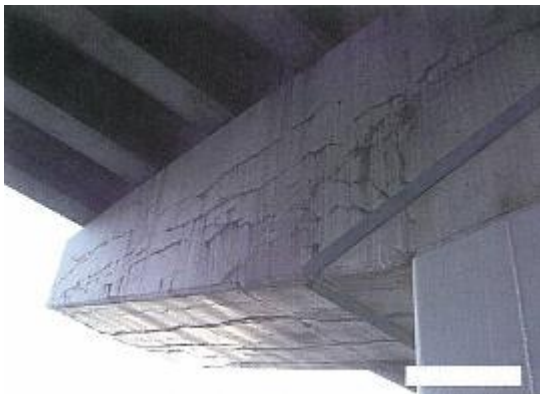
ASR と想定されるひびわれ（橋脚）
