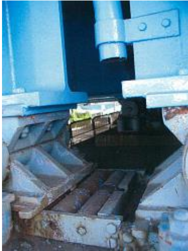
支承ローラーの脱落
