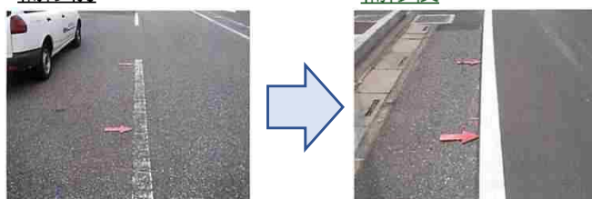
▲消えかけた区画線の修繕 出典：路面表示と交通安全（全国道路標識・標示業東京都協会）
