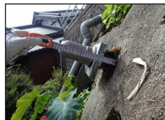
図-2 ロックボルト頭部の浮き
