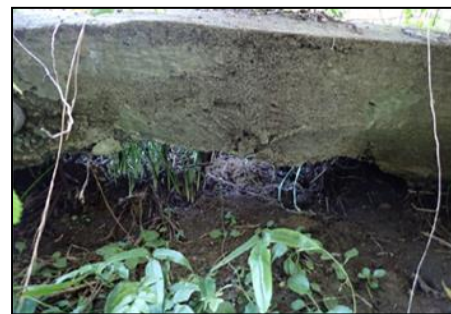
図-5 法枠と地山間の空洞
