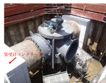
図 5-3 切替弁設置後の既設管φ1500mm
