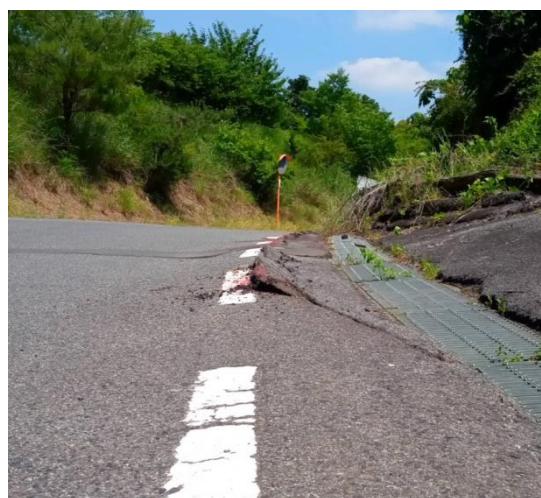
図-3 盤膨れした道路
