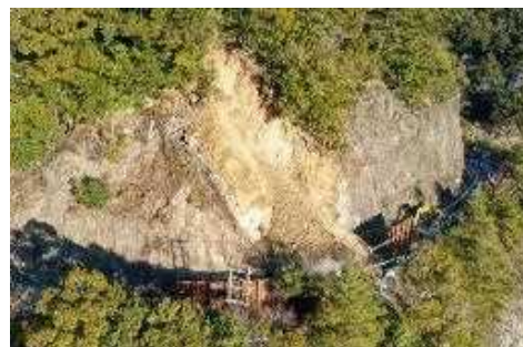
図 2. 被災状況(令和 5 年 12 月 24 日撮影)
