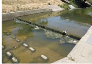
ごみの滞留(岡崎川)
