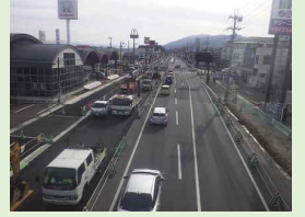
4車線への拡幅工事を推進【令和6年度一部供用(香芝市北今市～王寺町富田4丁目)】
