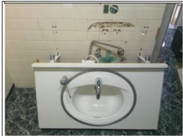
〈洗面台の落下〉
