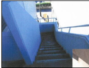
〈階段：手すり未設置〉
