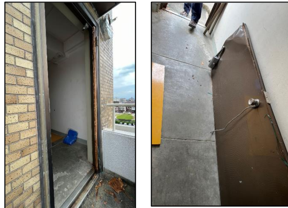
〈屋上ドアの破損〉
