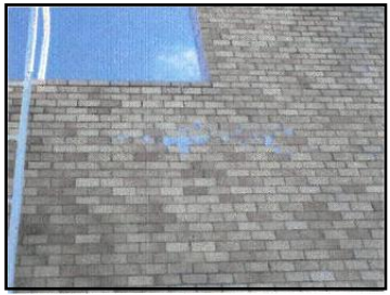
〈外壁：タイルクラック〉
