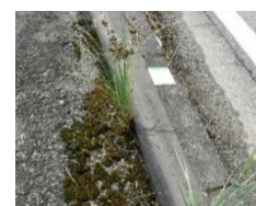
写真1 雑草繁茂状況 (シールタイプ)
