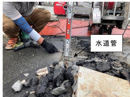
図-1 アスファルトカッター使用時に 水道管が露出した際の写真
