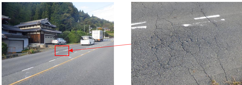
図-4 急勾配部の交差点滞留区間における損傷状況(一般国道 165 号室生大野地内)
