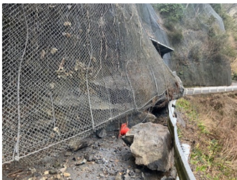
写真1. 国道425号 十津川村高滝 (R6.3.7発生)
