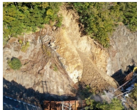
写真2. 国道169号 下北山村上池原 (R5.12.23発生)
