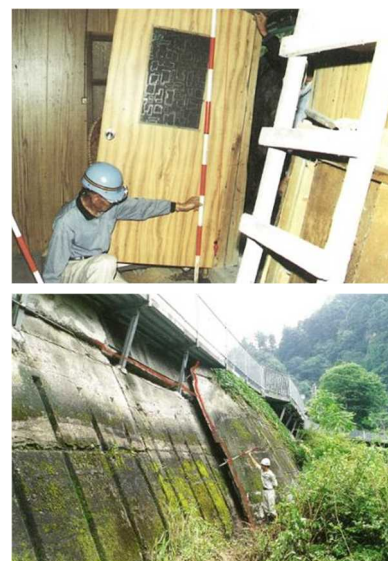
図 3. 地すべりによる 家屋等への被害 (H7)
