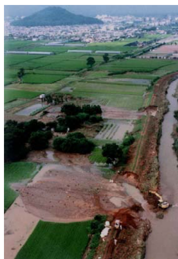
平成10年8月洪水(寺川堤防の決壊)
