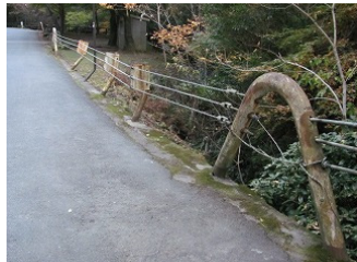
ガードケーブルの破損・劣化 (水谷茶屋付近)
