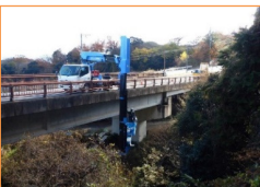
橋梁点検実施状況 (平群信貴山線 信貴山道橋) (平群町福貴)
