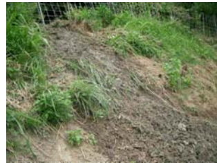
崩壊したキク圃場の法面
