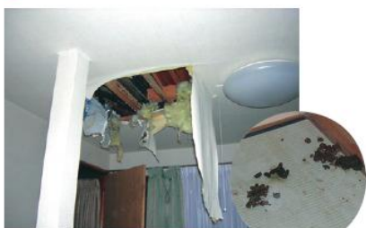
家屋侵入被害 （高槻市） 天井が破られ、床に糞
