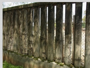
写真：老朽化が進行する鹿苑の外周柵
