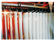
3機備えた大型冷凍機内。約16時間かけてゆっくと凍らす。
